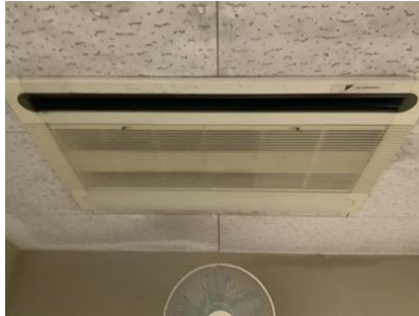
脱衣室エアコン周り
