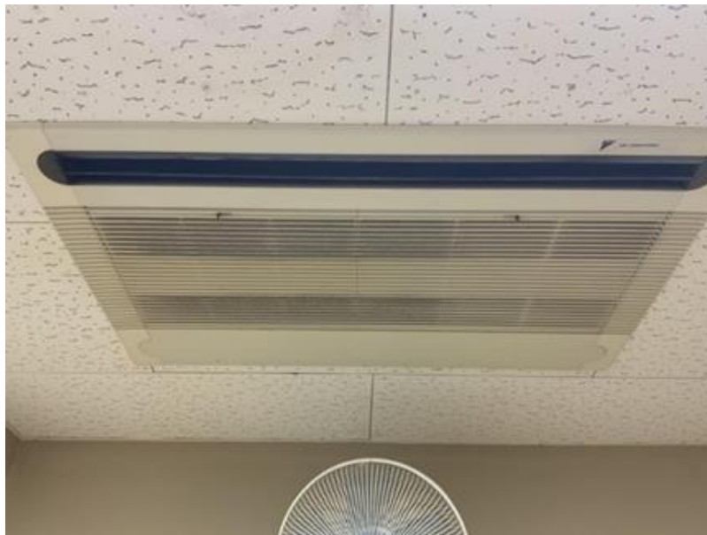
脱衣室エアコン周り
